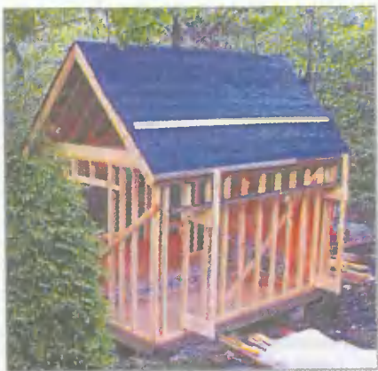
Кровля гостевой хижины из стандартных битумных кровельных плиток уложена по кровельному картону. Такая же плитка на крыше дачного дома автора
