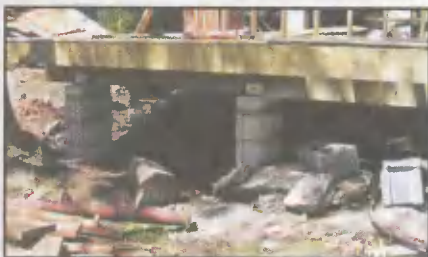
Чтобы пол хижинки был горизонтальным, на пологом склоне потребовались фундаментные столбы разной высоты
