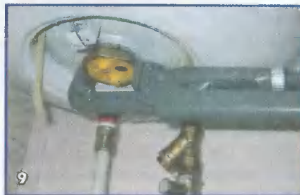
9 Гаечным (или газовым) ключом откручиваем гайку крепления блока ТЭНа с магниевым анодом...
