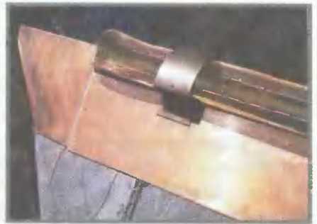
Медные фартуки покрывают коньки крыши из натурального шифера. Бронзовая сетка от насекомых обертывает сверху прорезь, оставленную в коньке крыши для проветривания, а к широким медным прихватам с резьбой для крепежных винтов будут привинчены перевернутые медные желоба
